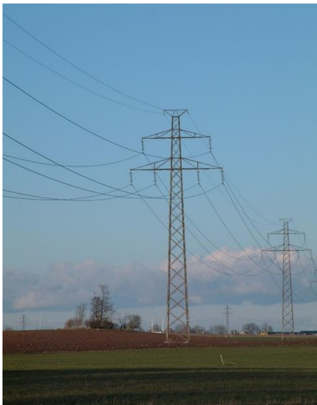
Figur 3. Fotografi över befintlig 2x130 kV luftledning Sege-Barsebäck.
